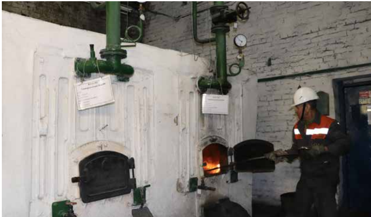
Угольная котельная в Ижевске
