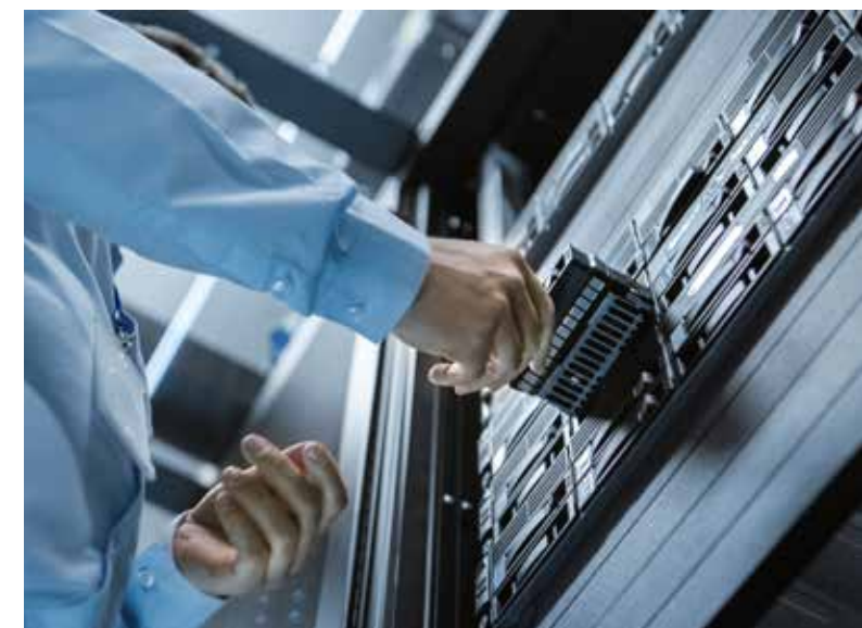
Дата-центр Источник: Gorodenkoff / depositphotos.com
