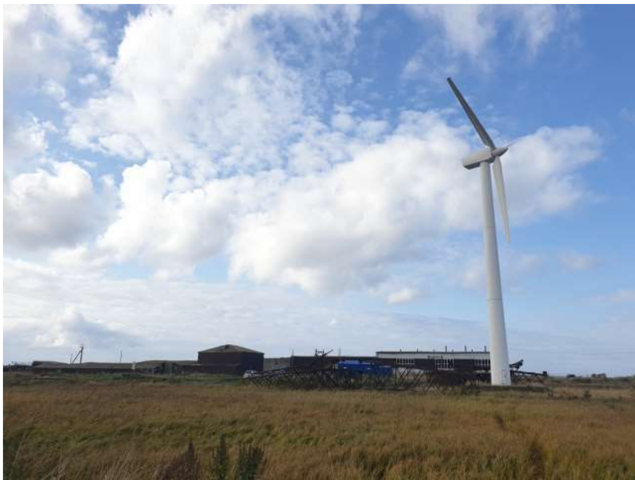
Ветродизельная электростанция в Новиково — один из немногих примеров гибридной генерации на российских изолированных территориях. Источник: фотография автора
